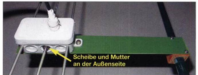
Bild 2: Ein hier grünes Glasfaserstück dient zur Befestigung der Dose am Mast.
